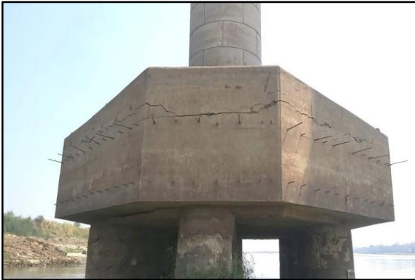
အရှည် ၂၀ မီတာခန့်၊အကျယ် ၂၅ မီလီမီတာခန့် Crack များ ဖြစ်ပေါ်နေပုံ
